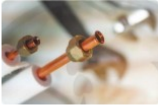
Ống dẫn ga ở điều hòa
