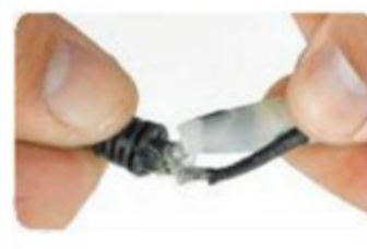
Hình 4: Dây điện bị sờn.
